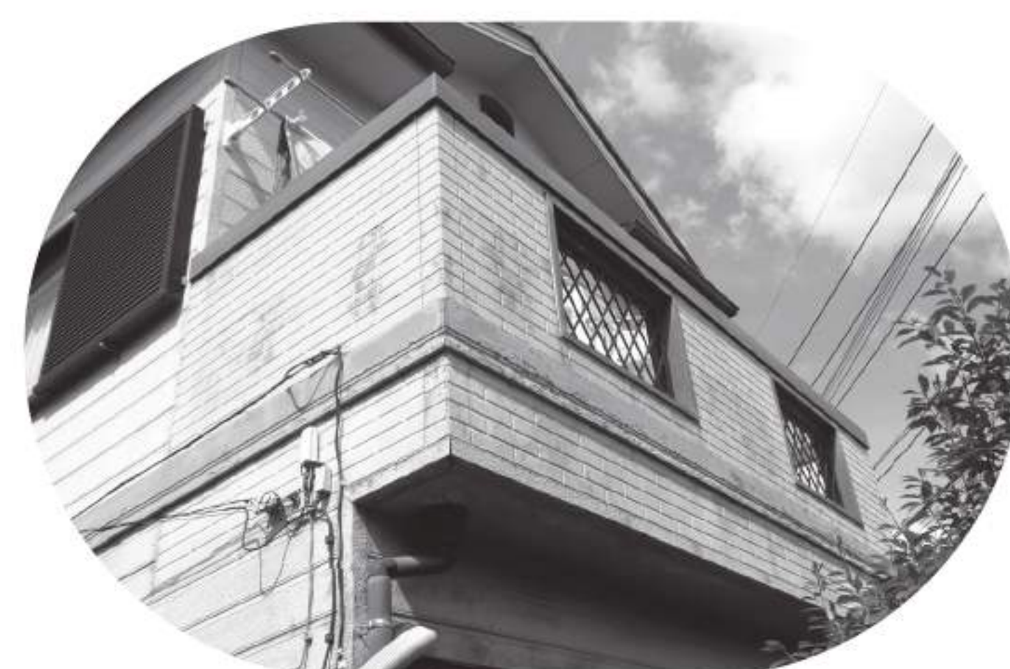
ベランダからの雨漏り
